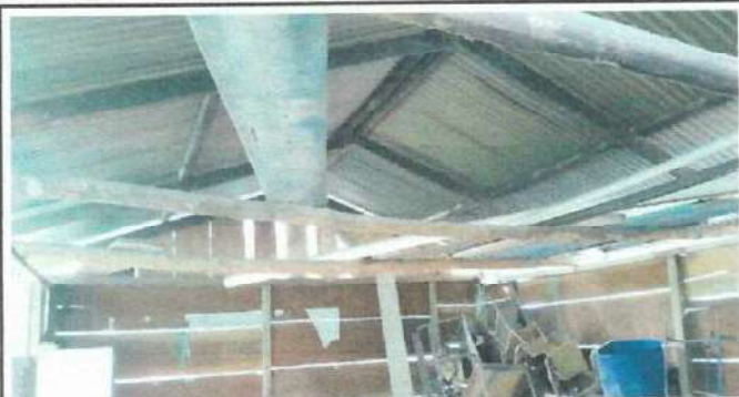
Foto1: En esta fotografia se evidencia la necesidad de rehabilitacion de aula.
